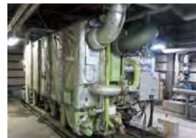
既存店で導入されていた重油式空調設備
