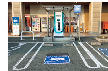
「ゆめタウン光の森」 EV充電スポット
