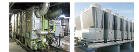
重油式の空調設備
