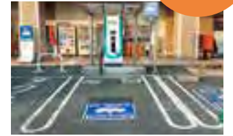
「ゆめタウン光の森」のEV充電スポット
