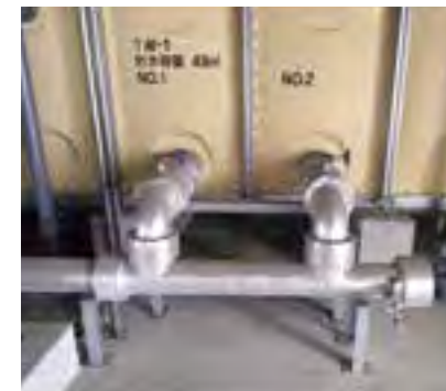
災害時用給水栓
